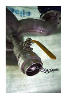
Priključek za izpiranje tlačnega voda
